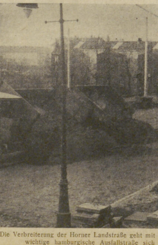
Die Verbreiterung der Horner Landstraße geht mit Macht vorwärts — In einigen Wochen wird die wichtige hamburgische Ausfallstraße sich verkehrstüchtiger denn je zeigen. Aufn.: Kaufauf
